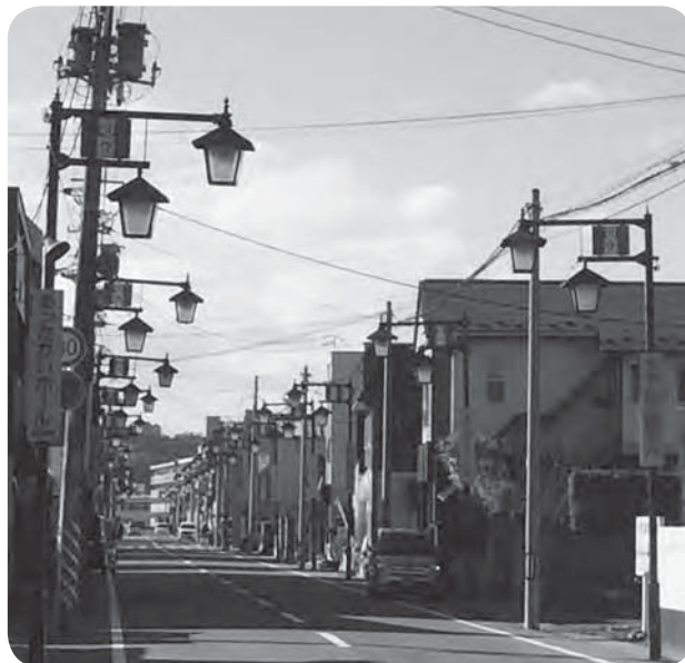
▲早急な改修が必要な街路灯
