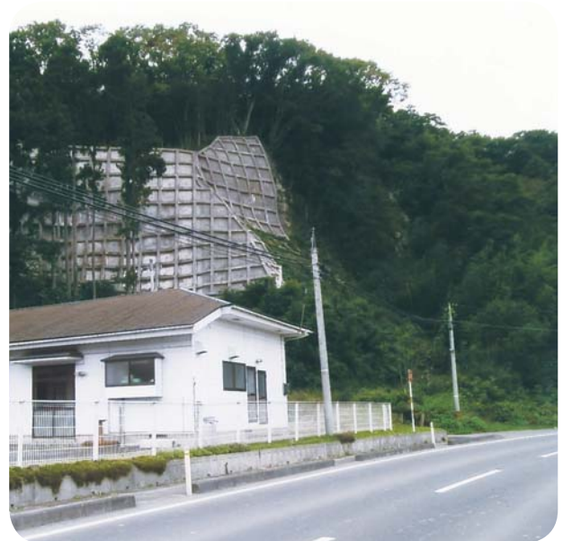
▲増工が待たれる浅井地区センター裏山の崖崩れ
