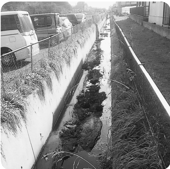
▲土砂等が堆積している長堀排水路
