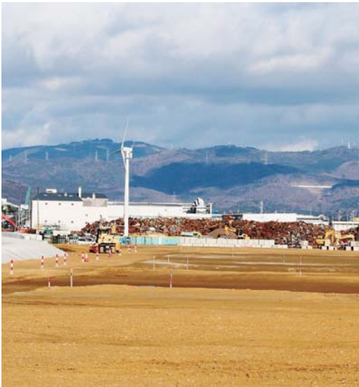
▲来春のオープンに向けて建設工事が進行中 (平成30年12月、上浜橋より撮影)
