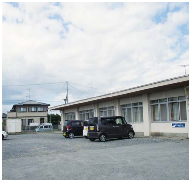
▲雨漏り、駐車場が狭い、南赤井地区学習等供用施設
