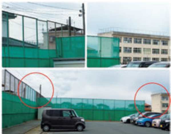
▲大曲小学校の不具合な飛砂防止ネット
