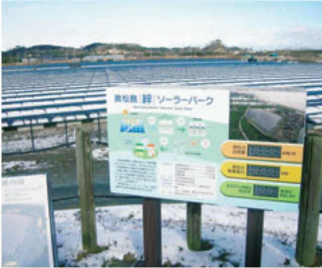
▲一般家庭600軒分の電気を賄える東松島「絆」ソーラーパーク
