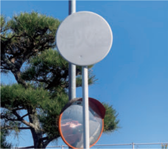
▲劣化した消防水利標識
