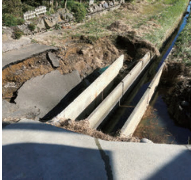
▲冠水による道路決壊の被災状況 (矢本字上館下)
