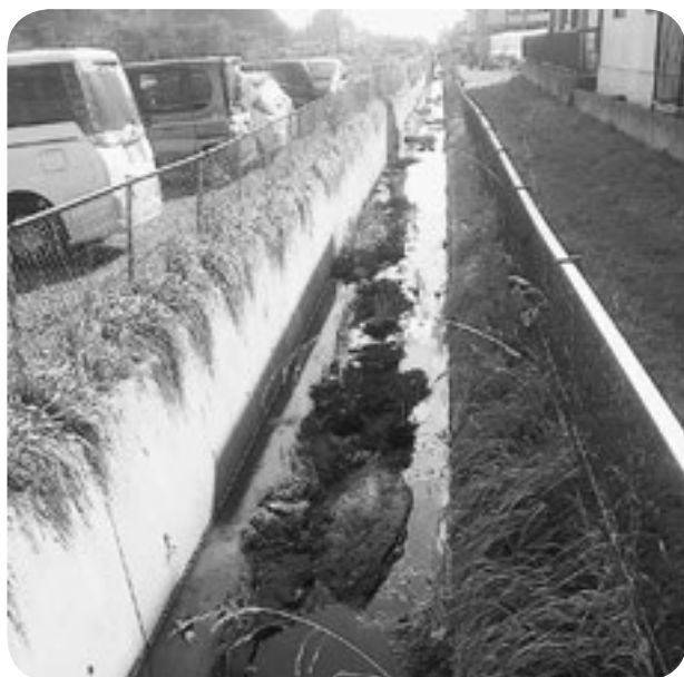
▲土砂等が堆積している長堀排水路
