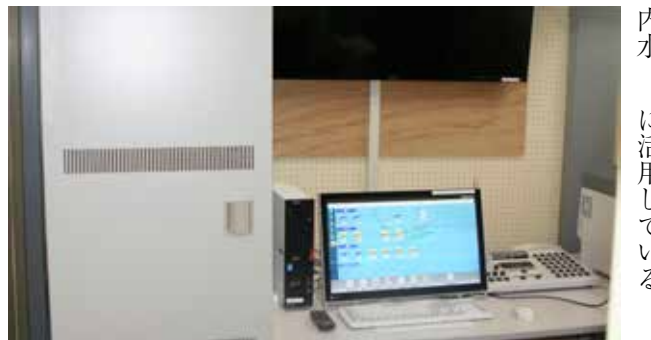
▲更新予定の防災行政無線操作卓
