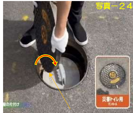
トイレ用鉄蓋 鍵穴に差し込む
