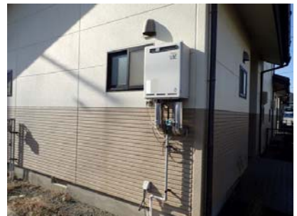
外壁に設置されたガス給湯器
