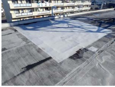
屋上防水シートの歪み(一部塗膜修繕)
