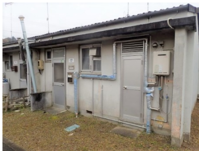
玄関脇の給湯器、浴室に通じる勝手口
