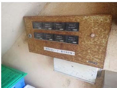
錆びが著しい水道メーター検針盤
