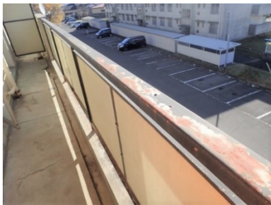
鉄部塗装が剥離したバルコニー手摺
