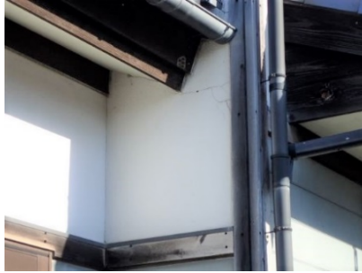
外壁のひび割れ
