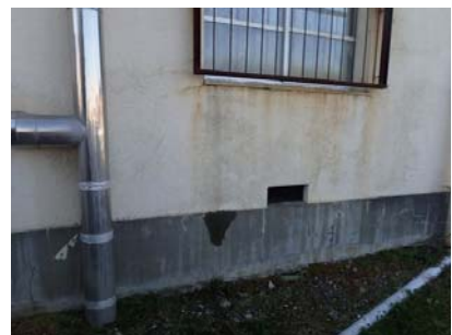
雨水が窓枠から外壁に浸潤している状態
