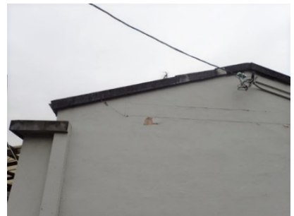
外壁の亀裂、ひび割れ
