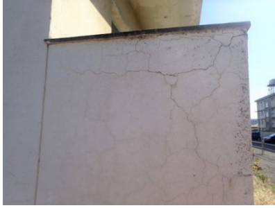
壁面(バルコニー)のひび割れ
