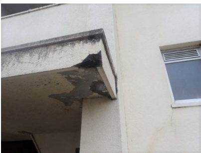
階段室入口(庇の破損、塗装剥がれ)
