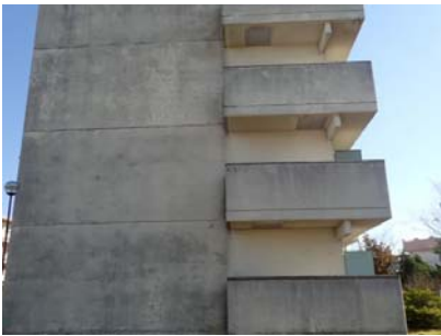
外壁の塗装剥離、ひび割れ
