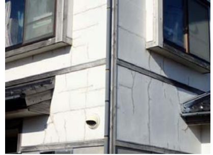
外壁ひび割れの補修跡
