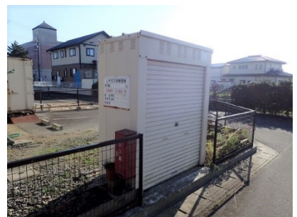
LPガス容器置場
