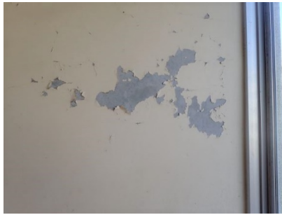
階段室壁の塗装剥がれ
