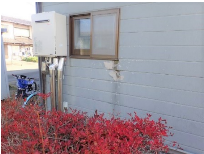
窓枠の結露跡と外壁の塗装剥がれ
