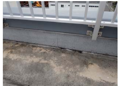
屋上目地の劣化箇所
