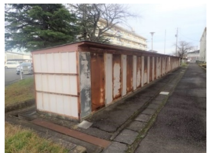
錆びが著しい屋外倉庫
