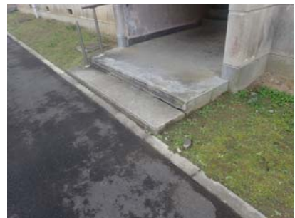
階段室入口(コンクリート亀裂、手摺破損)
