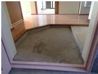
玄関上がり框の段差
