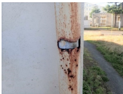
雨水排水管カバーの錆び、破損
