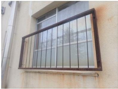
錆びが著しい窓の安全柵
