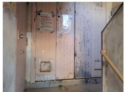
老朽化したパイプスペース扉
