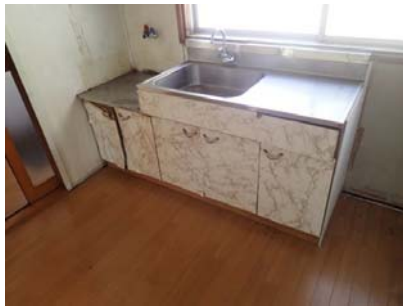
老朽化した流し台
