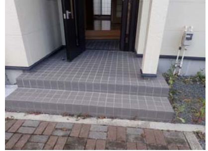
玄関の段差(手摺、スロープなし)
