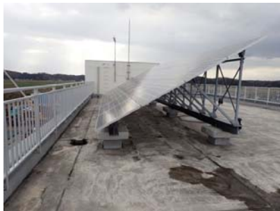
屋上のソーラーパネル
