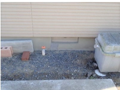
基礎部分に生じたコンクリート剥離
