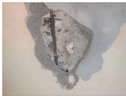
階段室天井の剥離、鉄筋露出
