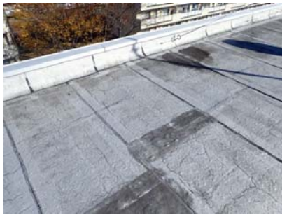
屋上アスファルト防水のひび割れ
