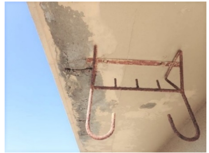
バルコニー庇の剥離、鉄筋露出
