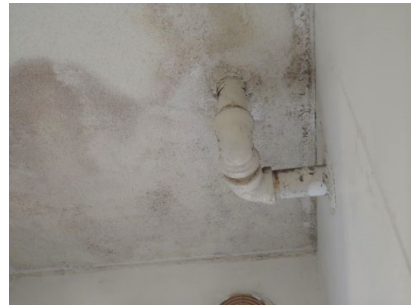
汚水排水管の塗装剥がれ、錆び
