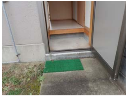
段差の大きな玄関(手摺なし)
