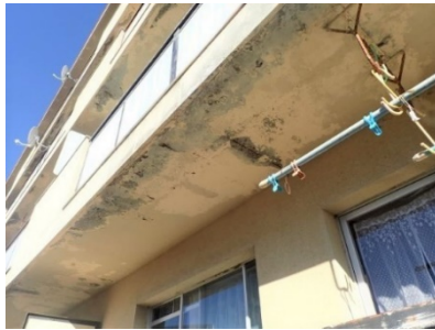
バルコニー庇の剥離、鉄筋露出
