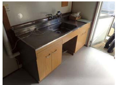
住戸内(流し台、3か所給湯ではない)
