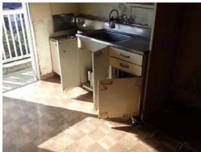
住戸内(老朽化した流し台)
