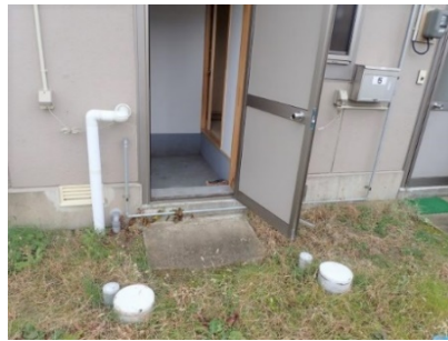
給水管とガス管、汚水処理設備
