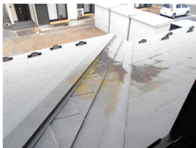
屋根トタン(亜鉛メッキ鋼板)の錆、汚れ
