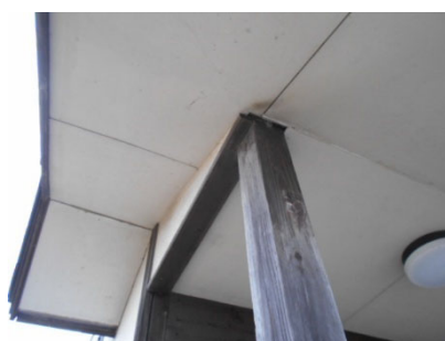
玄関柱の劣化、塗装剥離
