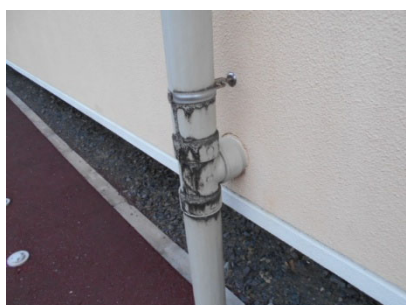
排水管の劣化
