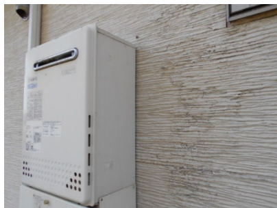
北側外壁面の汚れ等劣化
