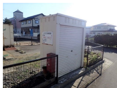
LPガス容器置場
