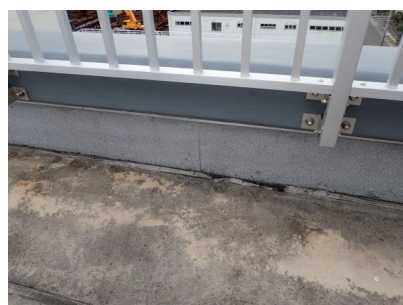
屋上目地の劣化箇所
