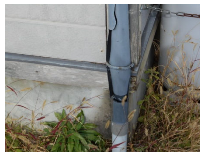
雨どい排水管の劣化
