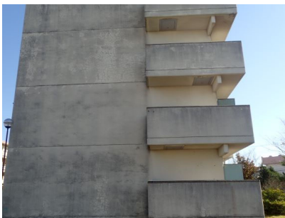
外壁の塗装剥離、ひび割れ
