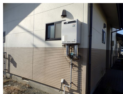
外壁に設置されたガス給湯器
