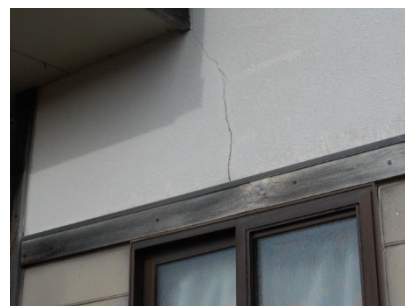
外壁のひび割れ
