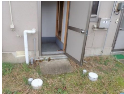
給水管とガス管、汚水処理設備
