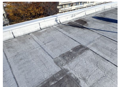
屋上アスファルト防水のひび割れ
