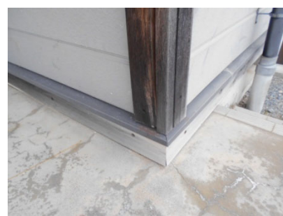
玄関柱の劣化、床面の亀裂
