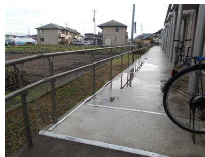
玄関前通路床面の歪み
