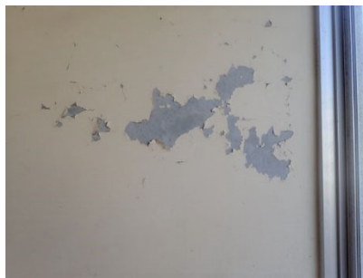
階段室壁の塗装剥がれ
