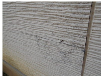
外壁材パネルの経年劣化
