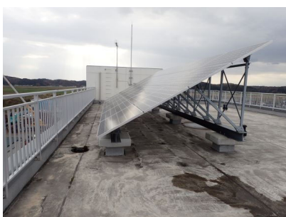
屋上のソーラーパネル
