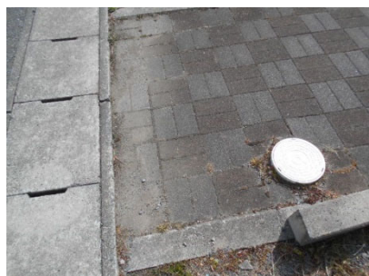
玄関前の地盤面のずれ
