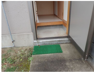
段差の大きな玄関(手摺なし)
