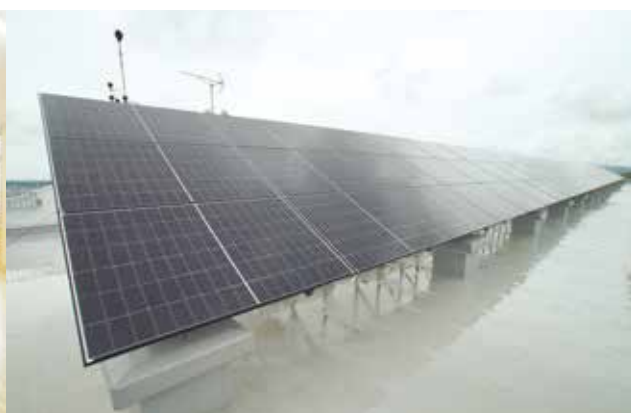
▲災害時の電源確保に役立つソーラーパネルを屋上に120枚設置
