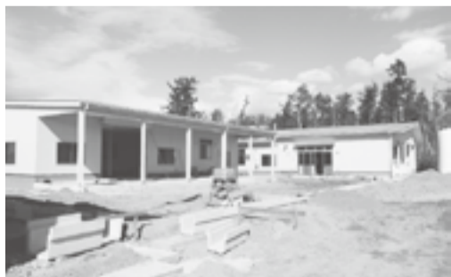
▶本格生産へ向け、整備されたのり共同加工施設 (浜市漁港前)
