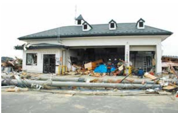
被災直後の矢本消防署鳴瀬出張所
