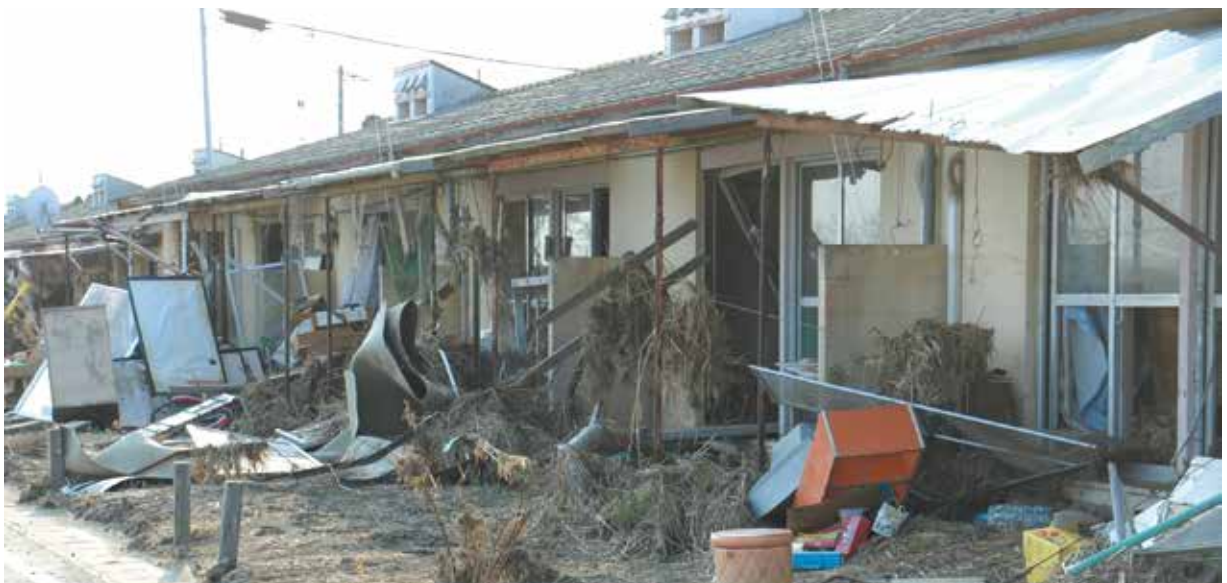
被災直後の市営立沼住宅
