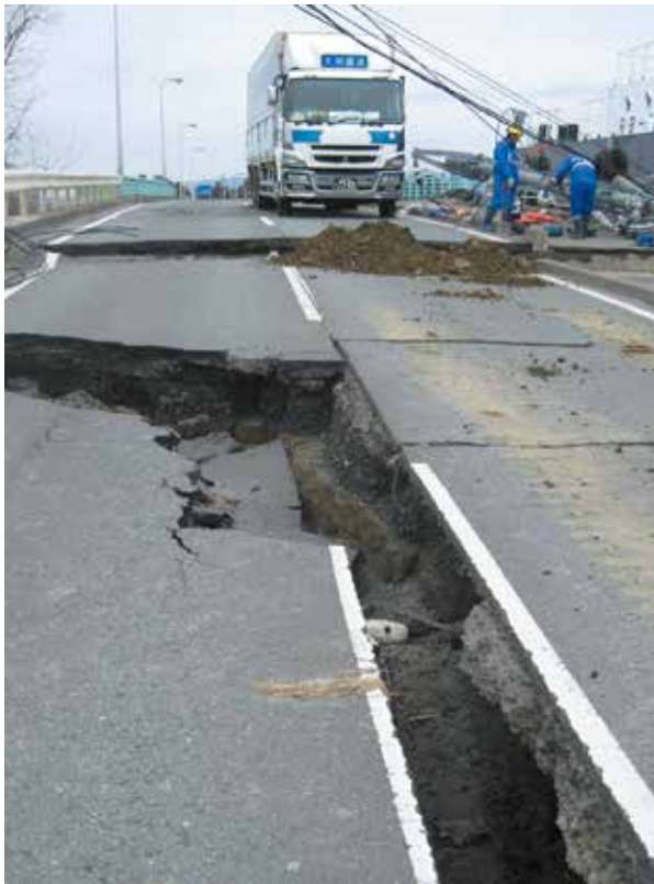
被災直後の定川大橋
