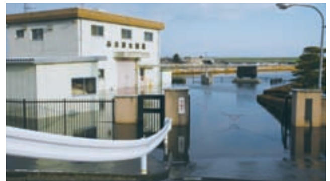
被災直後の赤井排水機場
