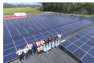
石巻市の大川中学校跡地に有効活用した「大川発電所」
