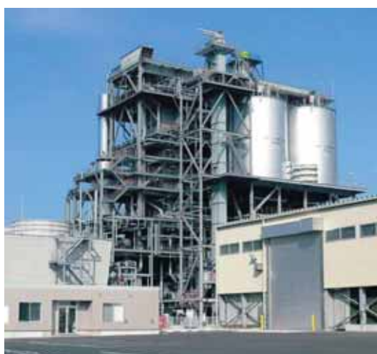
図表 1-25 バイオマス発電設備の例 13
