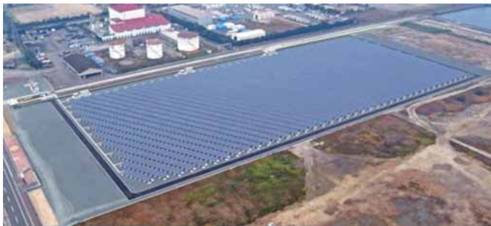
図表 1-23 大規模太陽光発電設備（メガソーラー）の例 10
