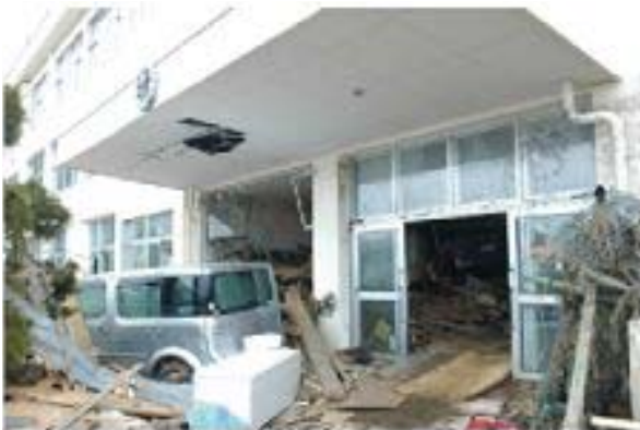
被災時の校舎（1階天井近くまで浸水）
