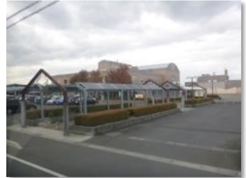
東松島市コミュニティセンター 東松島「絆」カーポートソーラー カーポートの屋根の上に計273kWの太陽光発電を設置。
