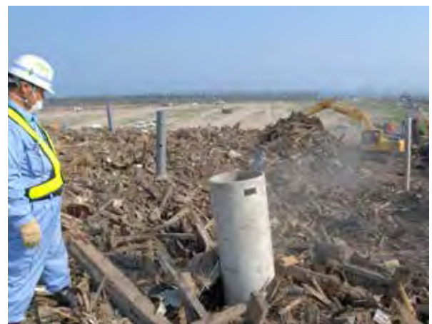
処理場には火災防止のため、熱を逃がす排気口を設置した
