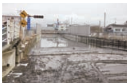
被災直後の県道矢本アンダーパス(掘下立体交差)
