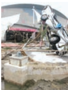
被災直後の奥松島体育館(パウンズ 88)
