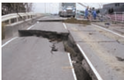
被災直後の定川大橋
