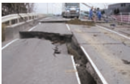
被災直後の定川大橋
